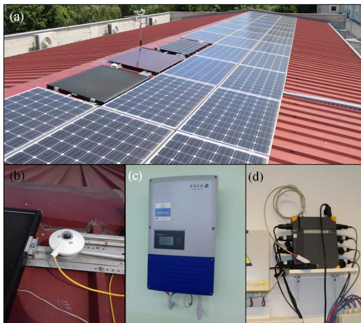
Slika 2. Oprema za mjerenja: (a) Moduli FN elektrane; (b) Piranometar Kipp&Zonnen SMP3; (c) Izmjenjivač Kaco Powador 12.0 TL3; (d) Mrežni analizator Fluke 1760
